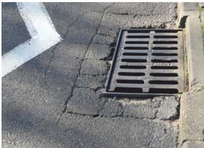
Wyeksploatowany wpust jezdniowy. Lokalizacja niekorzystna - cykliczne najazdy autobusów. Pęknięcia nawierzchni spowodowane brakiem szczelności zwieńczenia, brakiem podbudowy.
