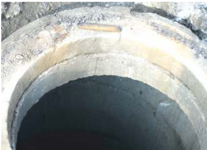
Degradacja konstrukcji wspierającej właz. Pręty zbrojeniowe jako materiał wyrównawczy - punktowe naciski niszczące.
