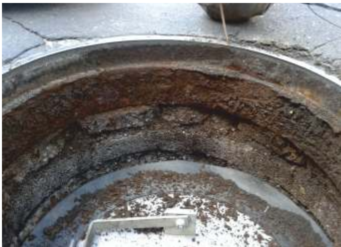
Degradacja konstrukcji wspierającej właz. Zaprawy betonowe w stanie niezwiązany pęknięte pierścienie wyrównawcze. Brak szczelności i nośności zwieńczenia.
