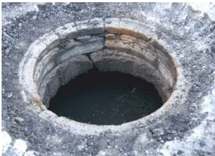
❶ Intensywna eksploatacja zwieńczenia studzienki. Całkowita degradacja pierścieni wyrównawczych, betonowych zapraw poziomująco łączących, pęknięcie płyty pokrywowej. Brak możliwości rehabilitacji zwieńczenia bez wymiany uszkodzonej płyty pokrywowej studni.
