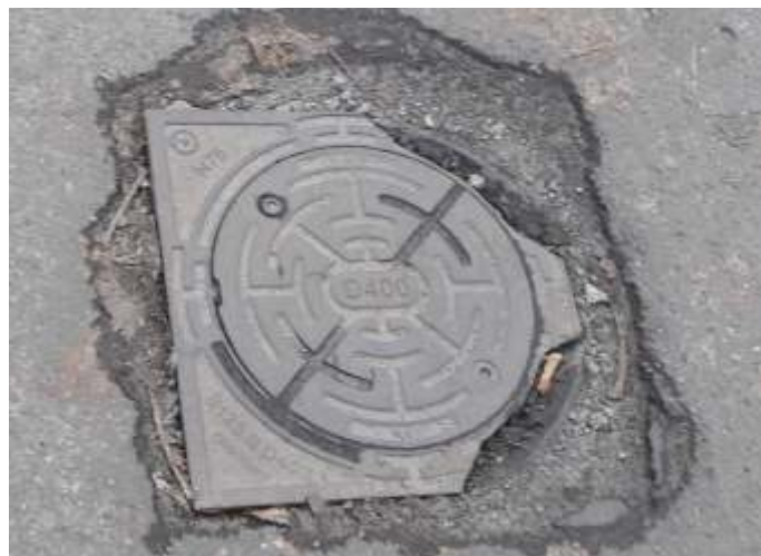
⚠ Wjazd teleskopowy do studzienki DN315 uszkodzony wskutek braku równomiernego, trwałego podparcia.
