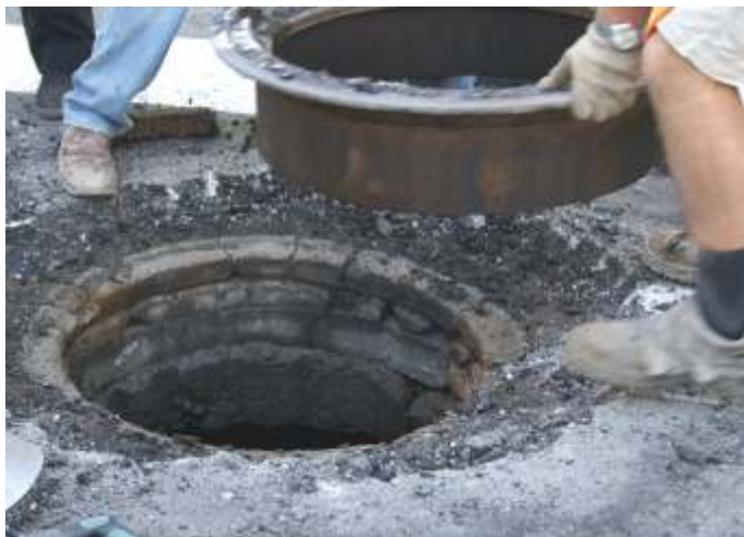
Demontaż włazu samopoziomującego o mniejszej powierzchni oparcia ramy (ok. 1600 cm 2 ) osadzonego bezpośrednio na elementach betonowych! Niekorzystne warunki środowiskowe. Czas eksploatacji 1,5 roku.
