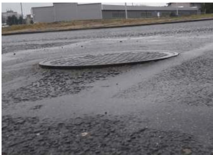
Właz wyniesiony nad poziom nawierzchni drogowej w skutek jej osiadania
