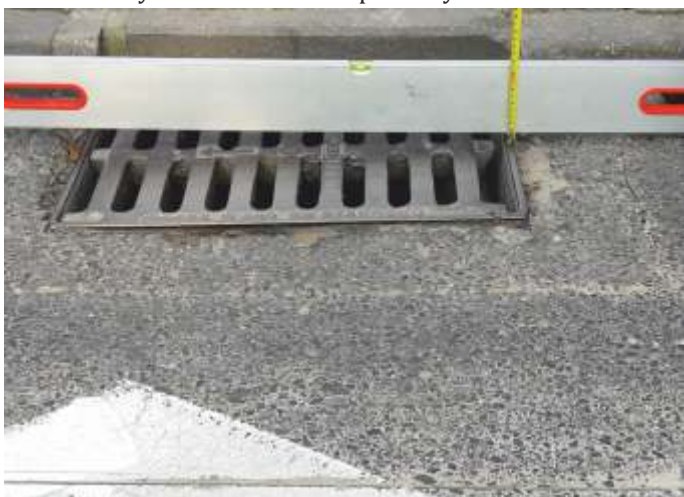
Weryfikacja stanu technicznego wpustu. Zapadnięty wpust. Obniżenie rusztu w ramie.
