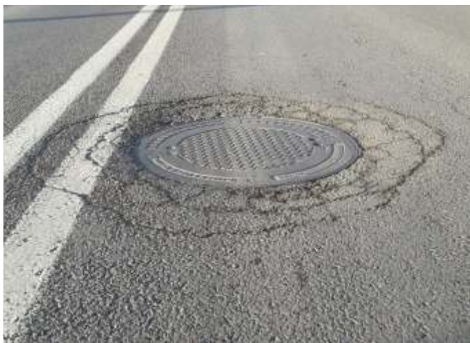
Zwieńczenie studzienki kanalizacyjnej zlokalizowanej centralnie w linii jazdy pojazdu. Obciążenie ruchem Kr 2-3. Degradacja elementów wspierających włazy, uszkodzenia podbudowy i spękania nawierzchni drogowej.
